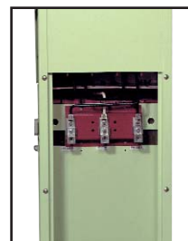
Utility Lug Landing
